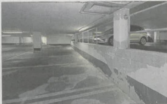
Die Schäden sind offensichtlich. Eine fehlende Abdichtung lässt Wasser und Tausalze ins Gebäude eindringen. (Foto: Hoene)
